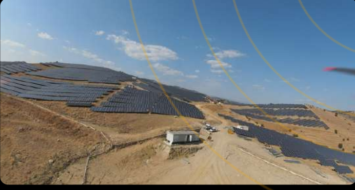
AYDIN - ÇİNE GES - 3500KWP
