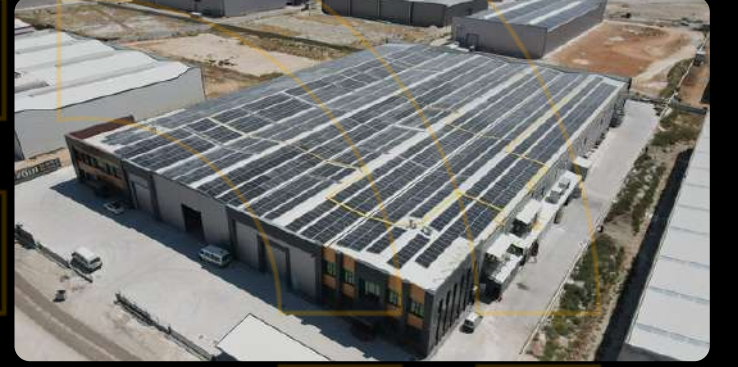
KONYA - PROPLAST GES - 1300KWP
